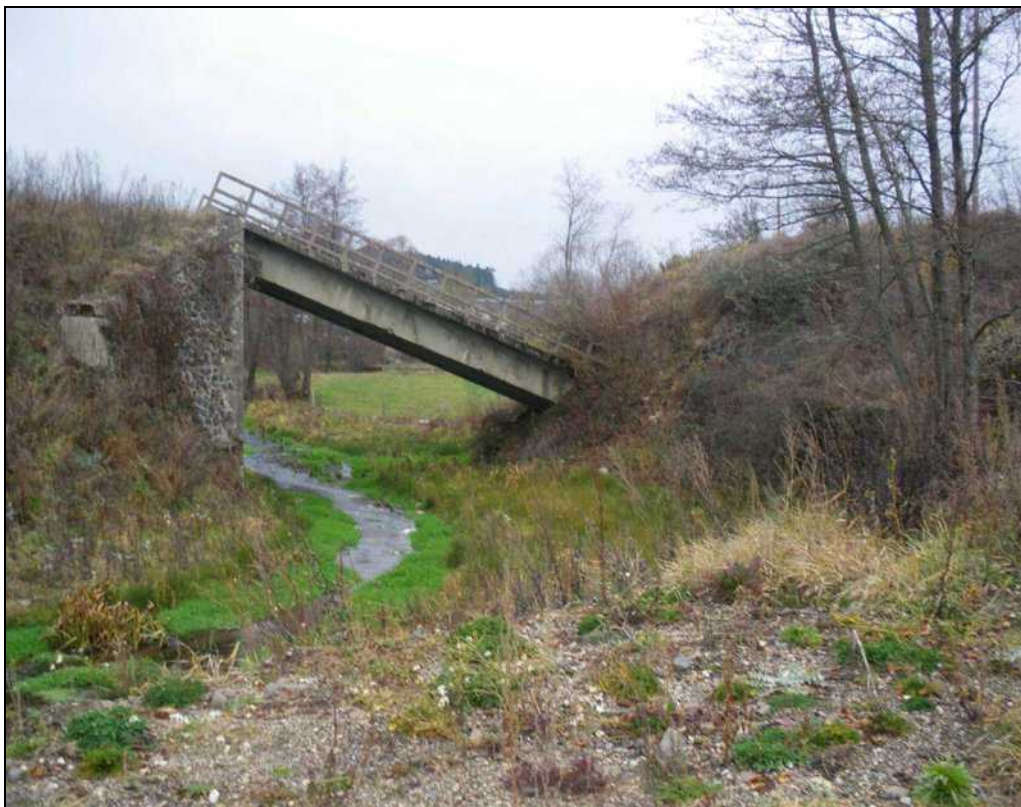
Effondrement du pont de Vendèze : illustration de l'agressivité d'un glissement (source LRPC, prise de vue décembre 2008)
