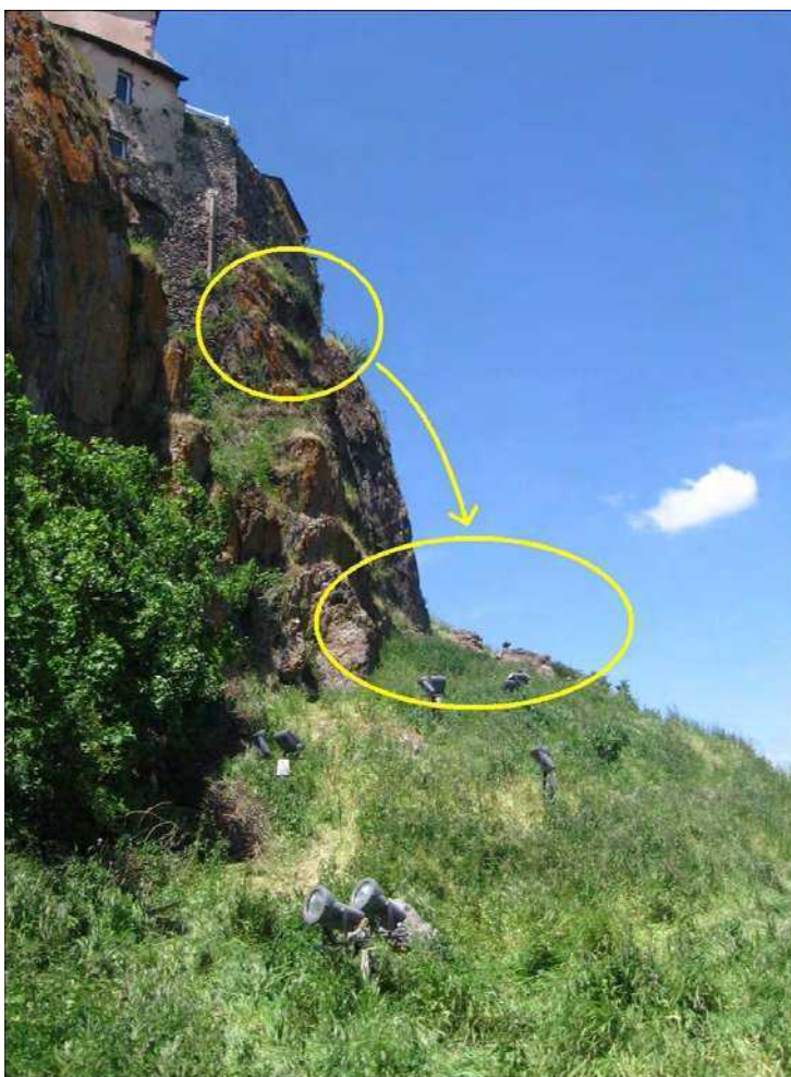
Chute de blocs en contrebas des maisons de la place J Brisson (source BRGM, prise de vue juin 2009)
