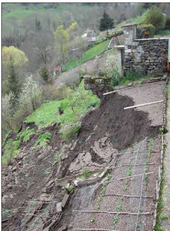
Glissement de terrain rue de Verdun (source LRPC, prise de vue mai 2004)
